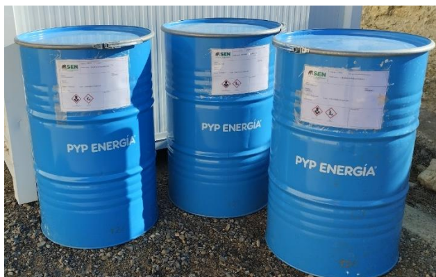
SET Virgen de la Peña, y último contenedor de oficinas y bidones de RP de VESTAS, pendientes de ser retirados
