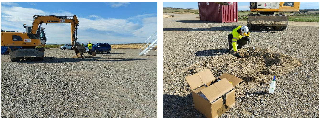
Toma de muestras en el punto en el que se produjo el derrame en la plataforma del SAR 01
