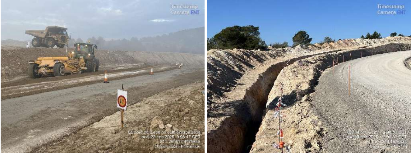
Imagen 1. Estado de obras en entronque con N-211 y zanjas de media tensión.
