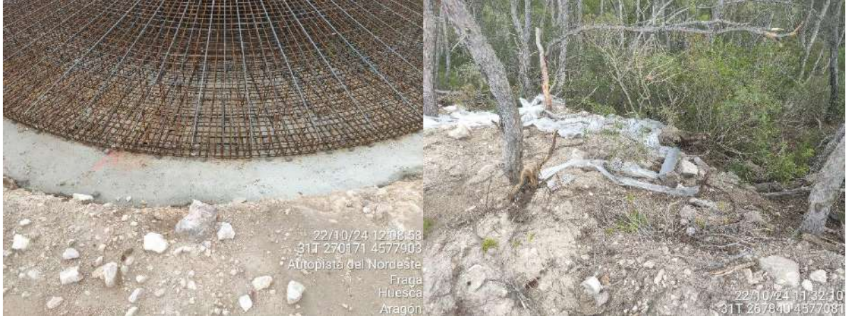
Restos metálicos en cimentación MR1-5. Restos plásticos en borde de plataforma MR1-7.
