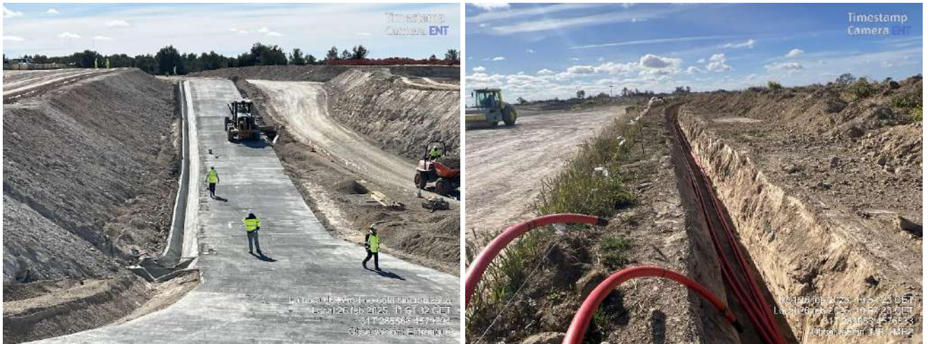
Imagen 1. Estado de obras en entronque con N-211 y zanjas de media tensión en MR1-2.
