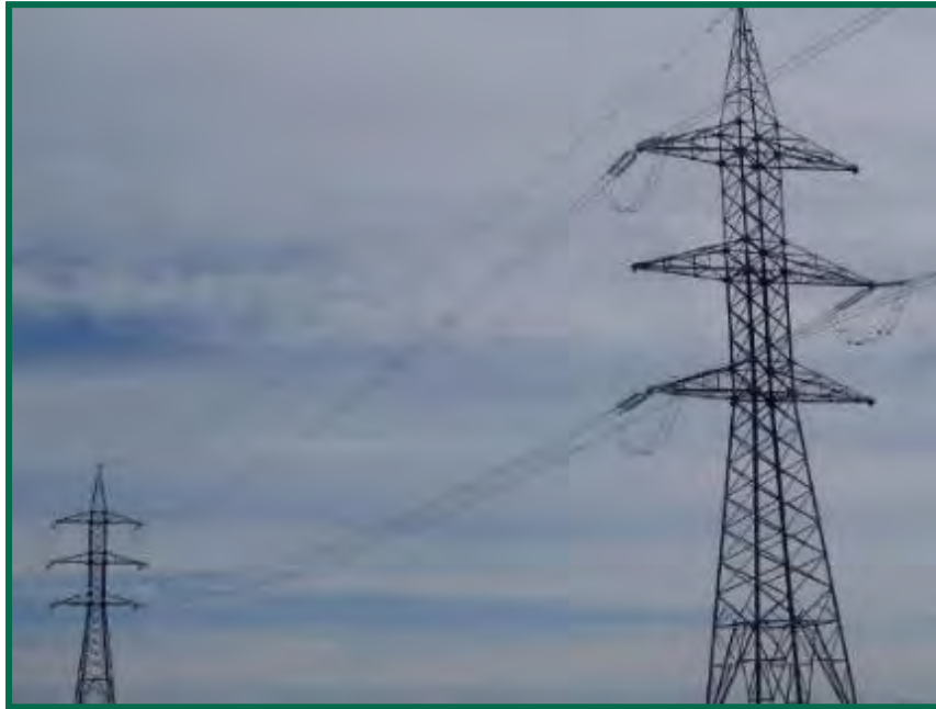
Fotografía 16. Apoyos de la LAAT de evacuación.
