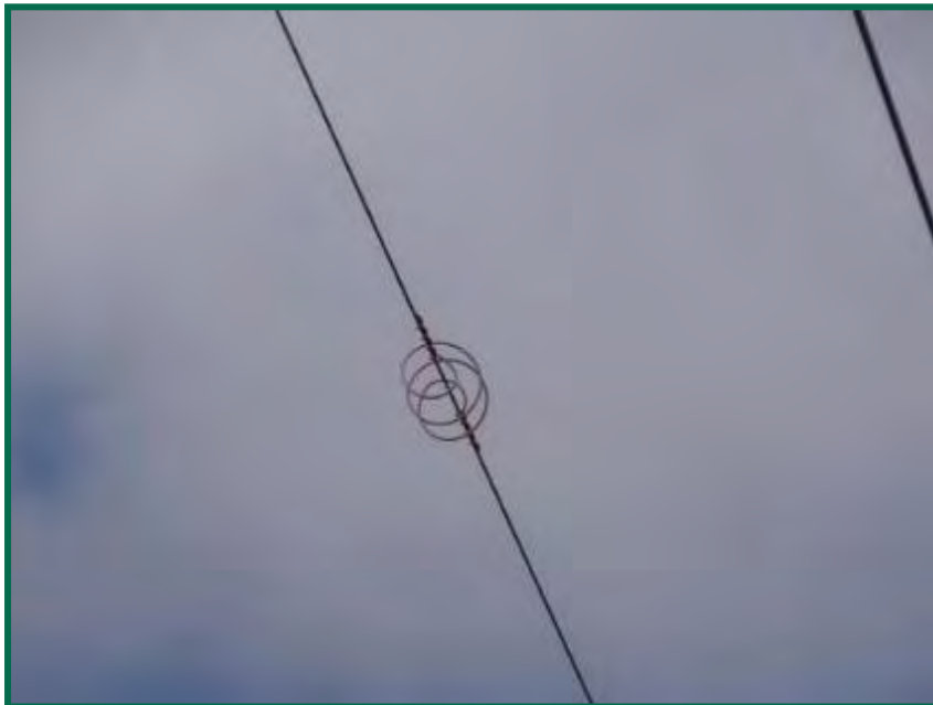
Fotografía 17. Detalle del sistema salvapájaros.
