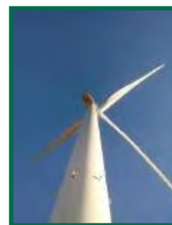
Fotografía 19. Sistemas de detección y disuasión instalados en aerogenerador.
