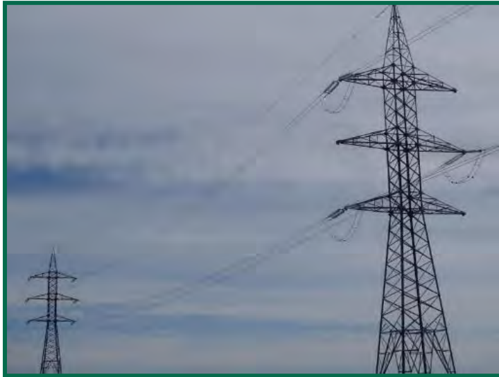
Fotografía 16. Apoyos de la LAAT de evacuación
