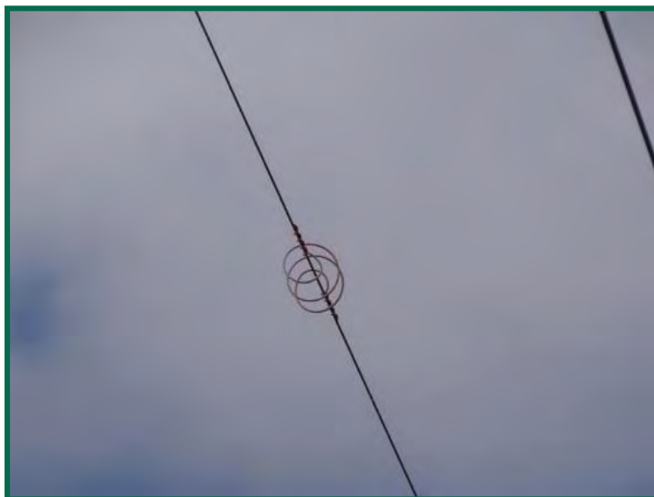
Fotografía 17. Detalle del sistema salvapájaros.
