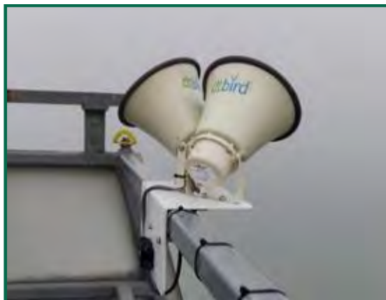
Fotografía 1. Sistema de anclaje de los altavoces.
