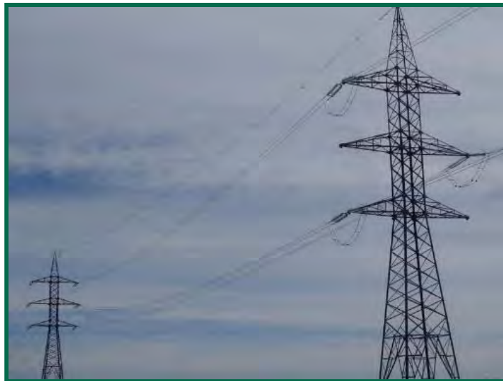
Fotografía 16. Apoyos de la LAAT de evacuación
