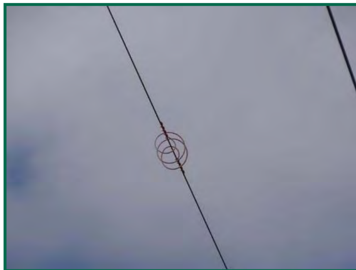
Fotografía 17. Detalle del sistema salvapájaros.
