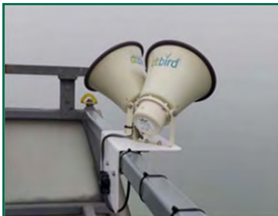
Fotografía 1. Sistema de anclaje de los altavoces.
