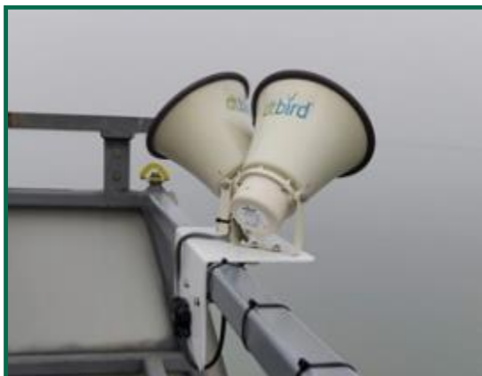
Fotografía 22. Sistema de anclaje de los altavoces.
