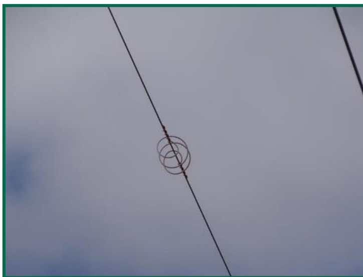
Fotografía 17. Detalle del sistema salvapájaros.
