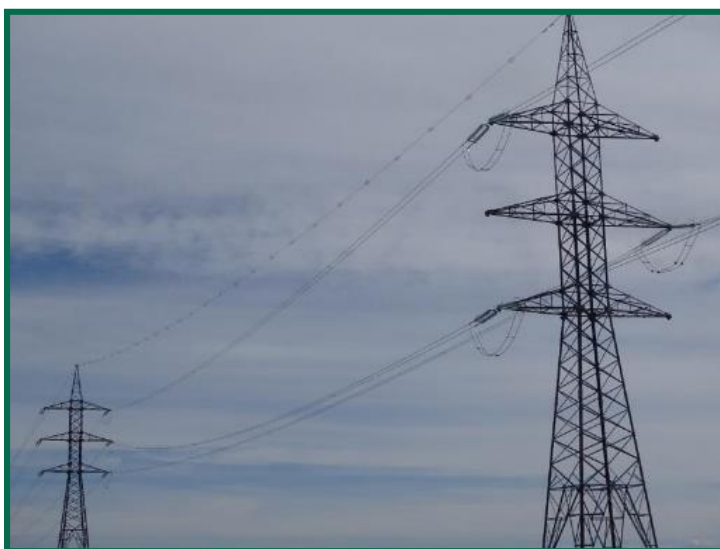
Fotografía 16. Apoyos de la LAAT de evacuación
