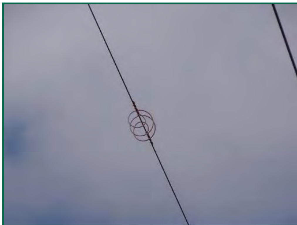
Fotografía 12. Detalle de balizas salvapájaros.
