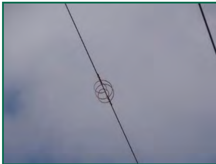
Fotografía 14. Detalle del sistema salvapájaros.
