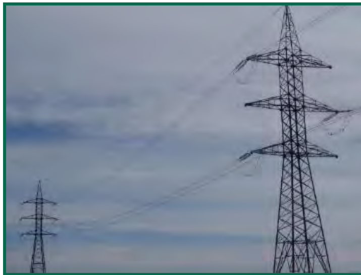
Fotografía 13. Apoyos LAAT de evacuación.
