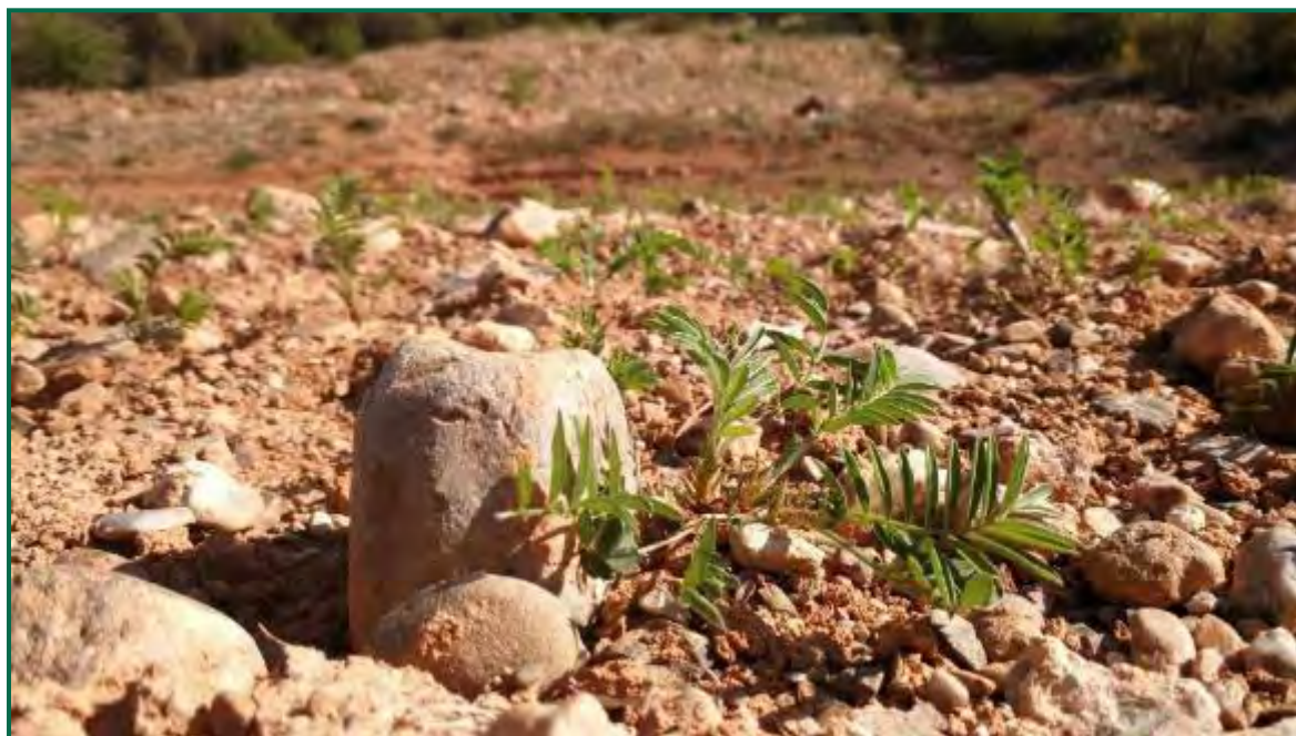
Fotografía 33. Talud con Onobrychis-viciifolia .
