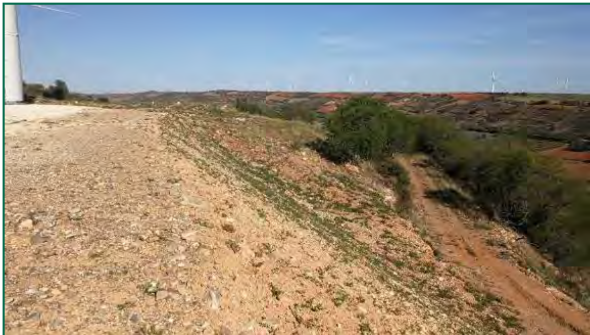
Fotografía 32. Talud en clúster Aguasvivas.
