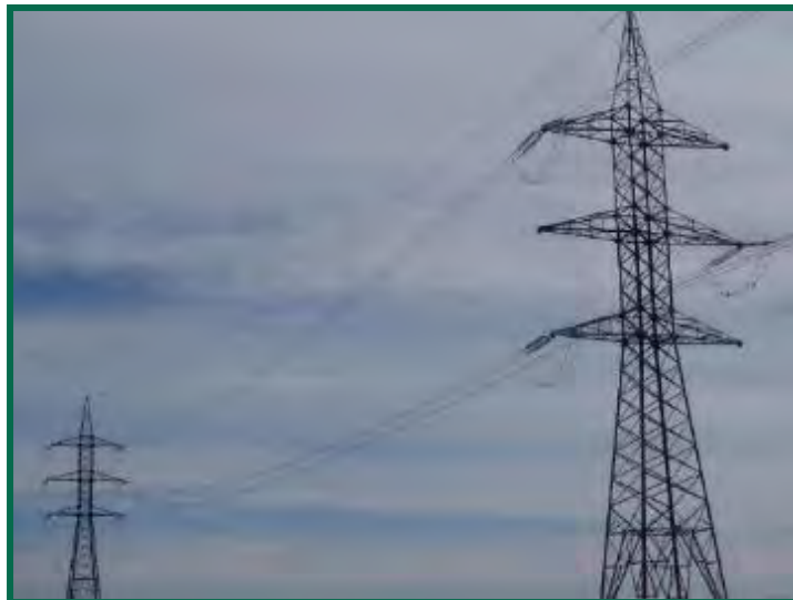
Fotografía 13. Apoyos LAAT de evacuación.
