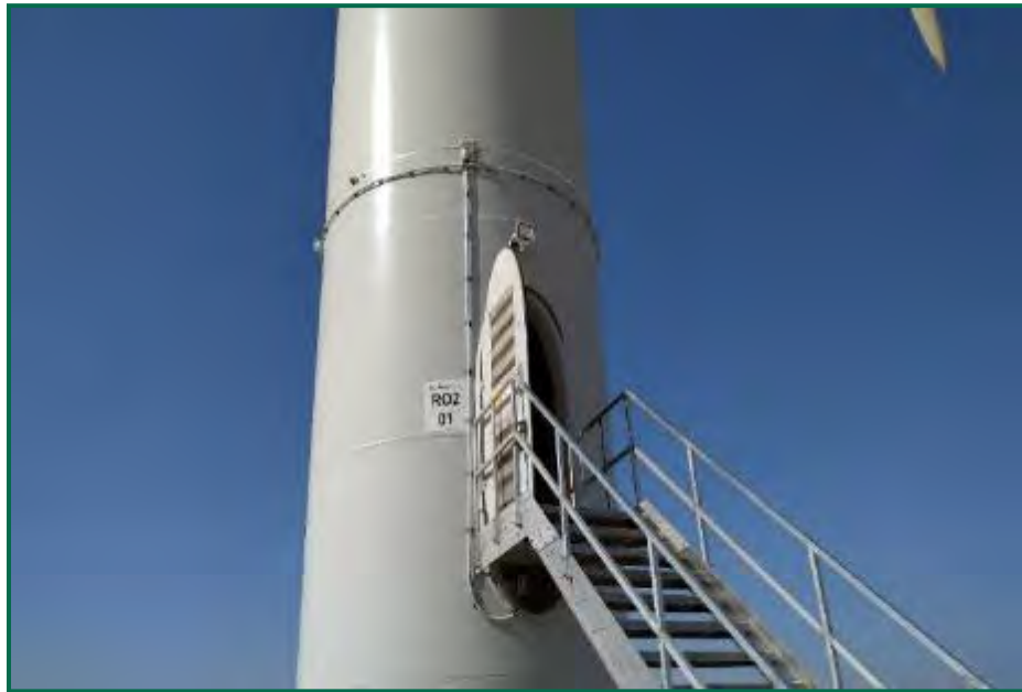
Fotografía 17. Nuevo sistema W4-D10, instalado.
