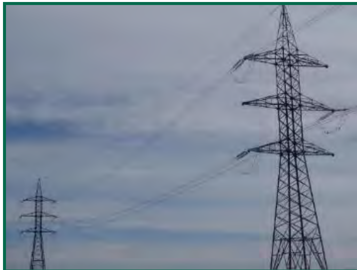
Fotografía 13. Apoyos LAAT de evacuación.
