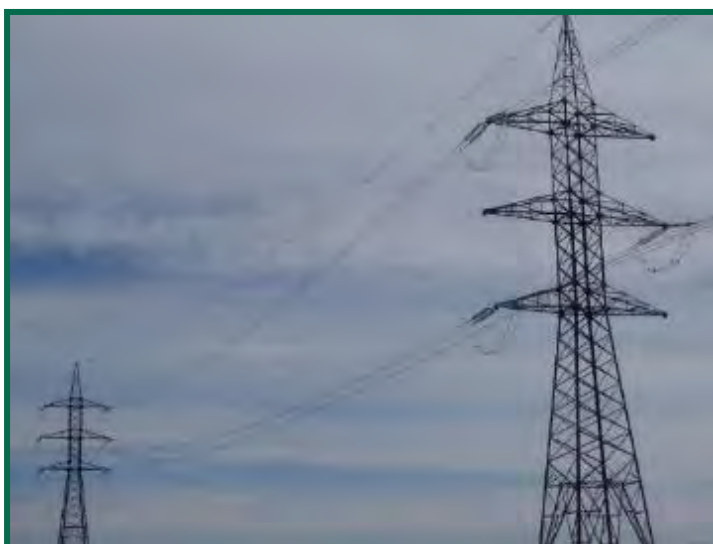
Fotografía 13. Apoyos LAAT de evacuación.
