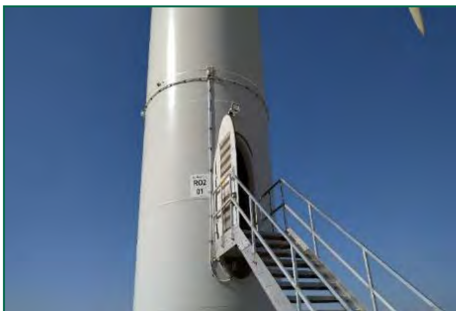
Fotografía 17. Nuevo sistema W4-D10, instalado.
