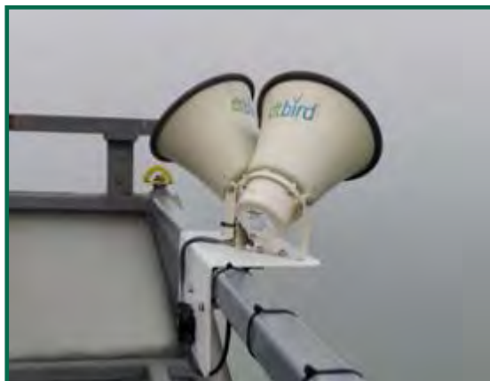
Fotografía 20. Sistema de anclaje de los altavoces.
