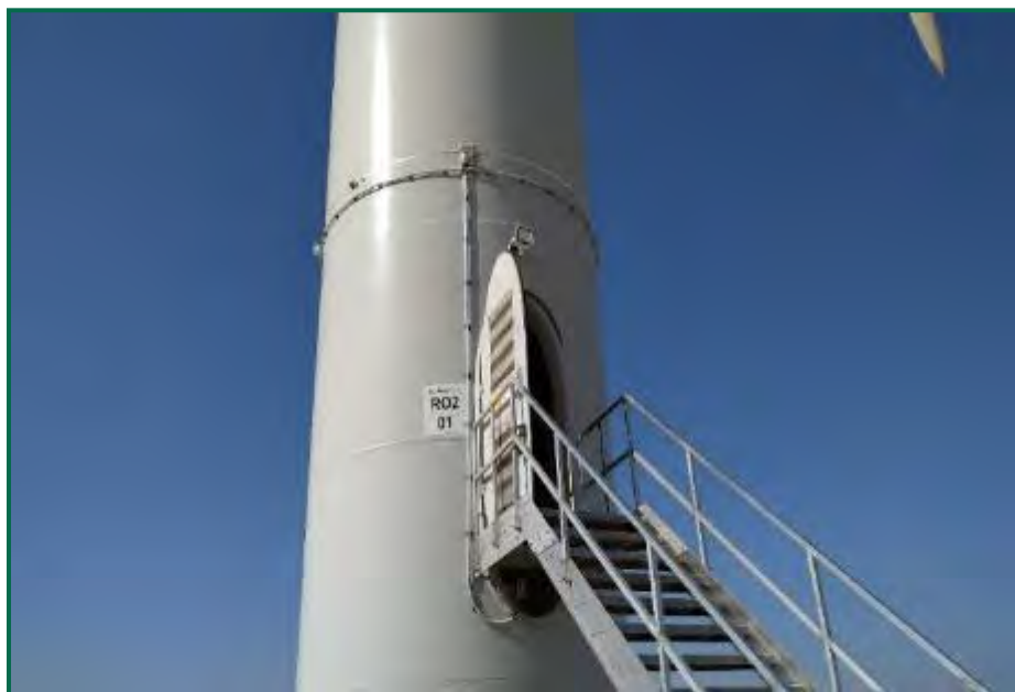
Fotografía 17. Nuevo sistema W4-D10, instalado.
