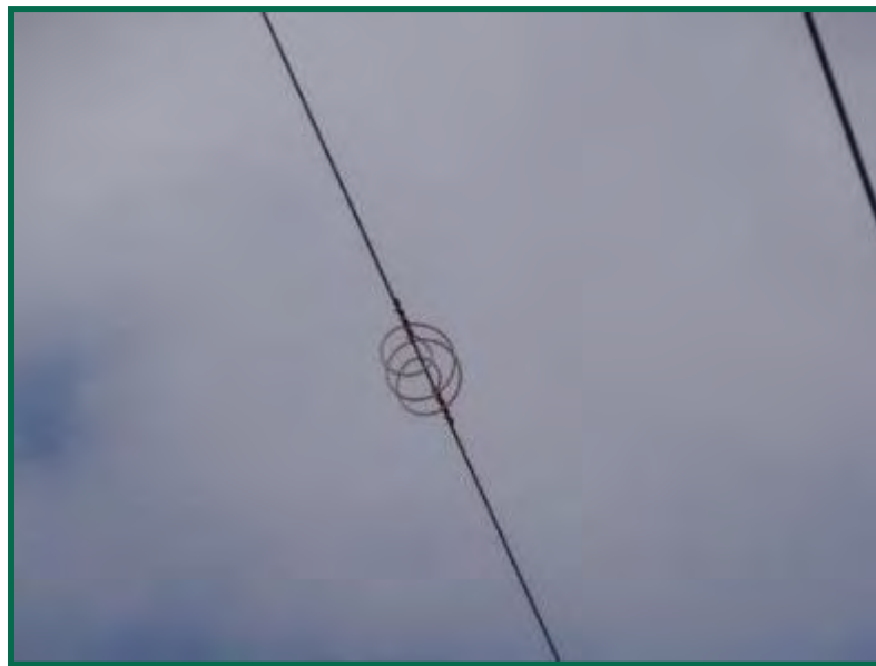
Fotografía 14. Detalle del sistema anti pájaros de la LAAT de evacuación.
