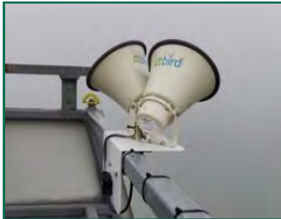
Fotografía 1. Sistema de anclaje de los altavoces.
