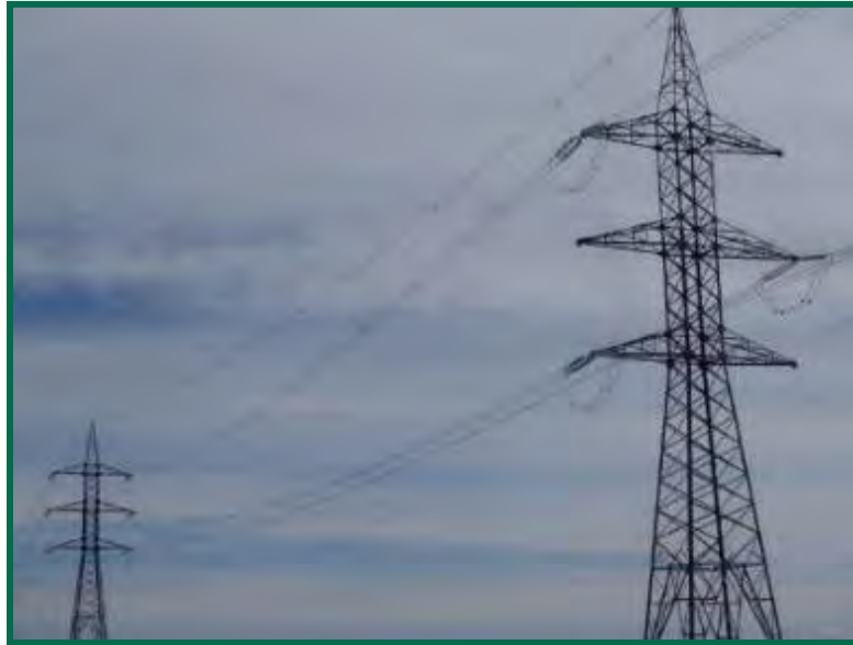
Fotografía 13. Apoyos de la LAAT de evacuación.
