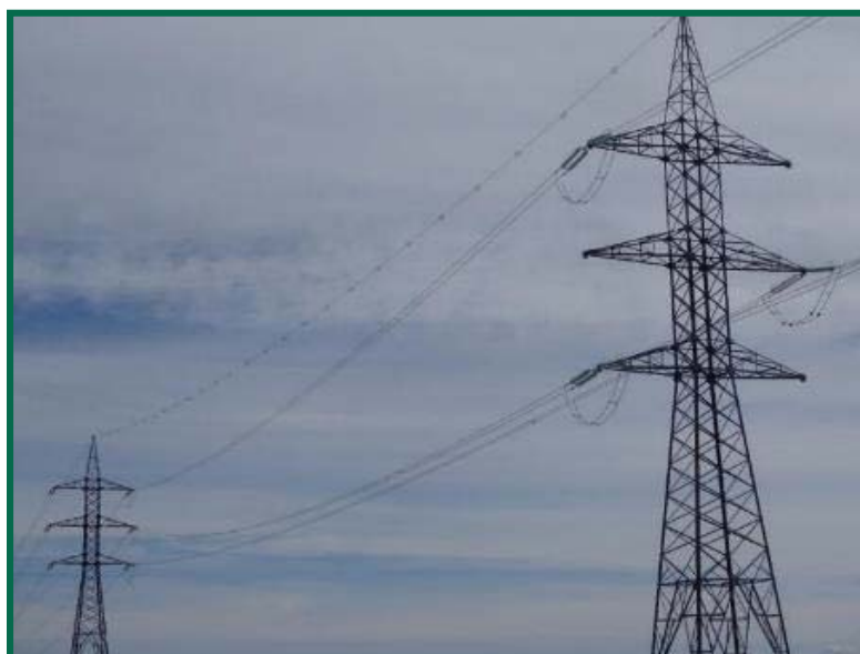
Fotografía 14. Apoyos de la LAAT de evacuación
