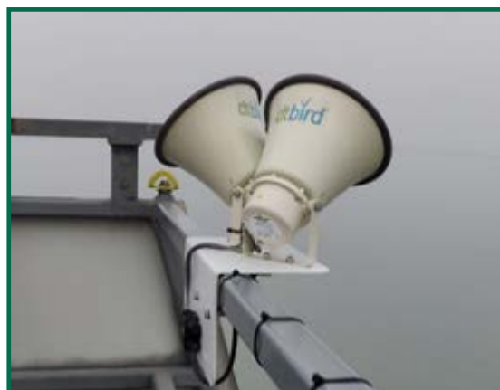
Fotografía 1. Sistema de anclaje de los altavoces.
