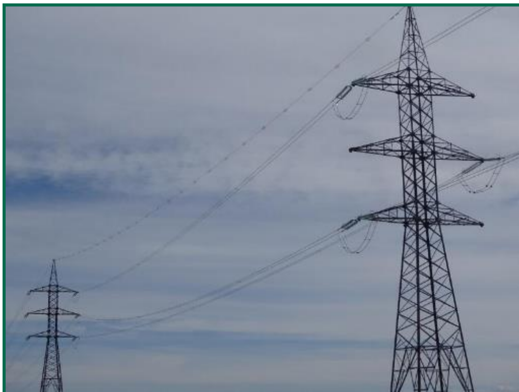
Fotografía 13. Apoyos de la LAAT de evacuación.
