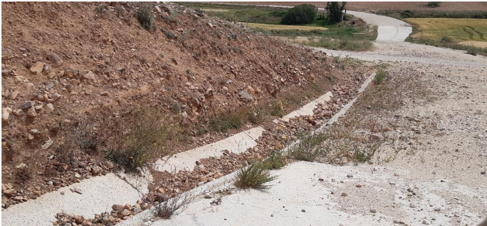
Foto 1. Cuneta llena de piedras en vial de acceso al aero L6D – 04.
