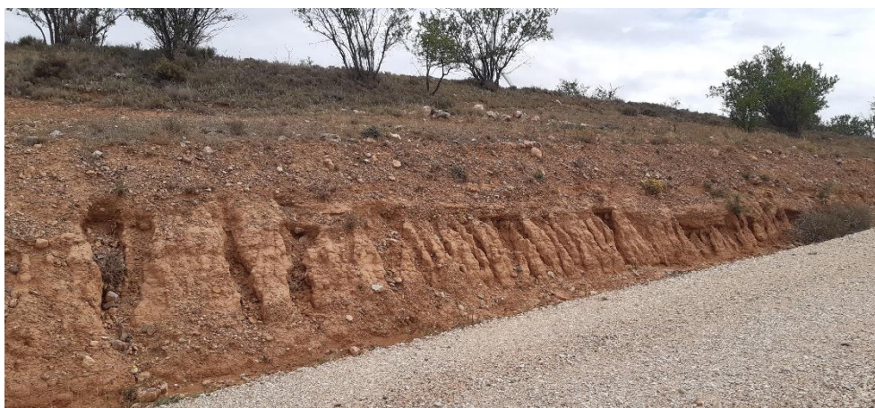
Foto 2. Erosión hídrica en materiales lutíticos del talud de desmonte del vial de acceso al aero L6D – 03.
