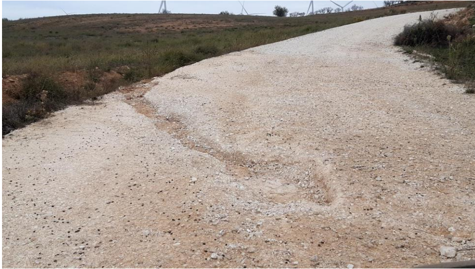
Foto 3. Erosión hídrica en materiales detríticos del vial de acceso al aerogenerador L6C – 11.
