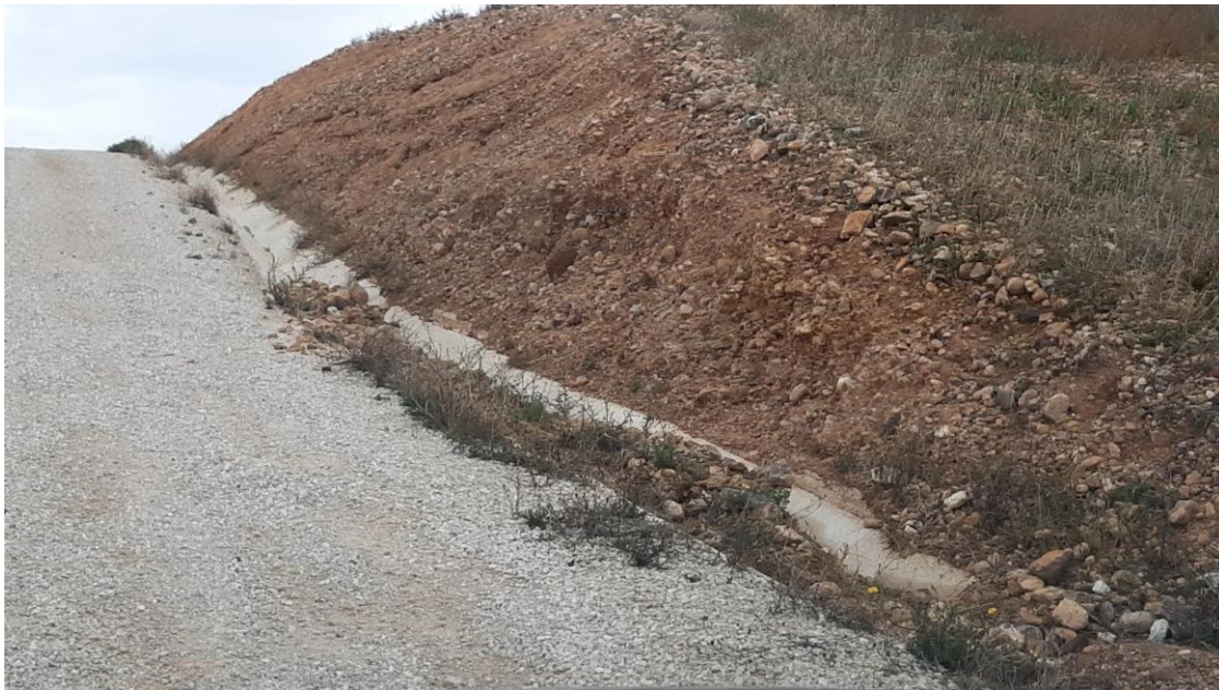
Foto 2. Cuneta llena de sedimentos y vegetación arbustiva en vial de acceso al aerogenerador L6C – 07.
