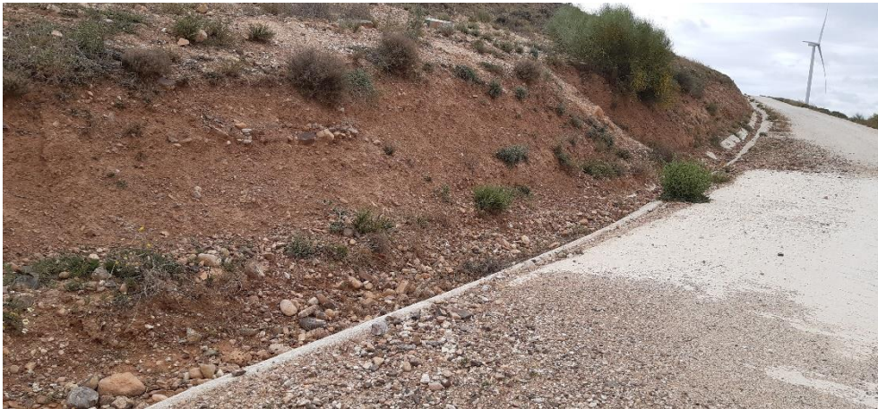
Foto 2. Cuneta llena de sedimentos y rocas en vial de acceso al aerogenerador L6C – 12.
