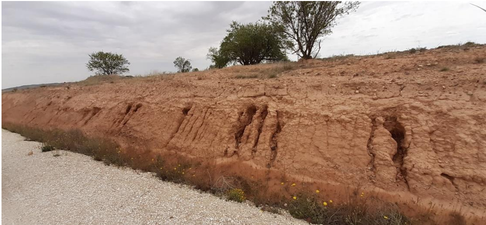
Foto 3. Erosión hídrica en materiales lutíticos del talud de desmonte del vial de acceso al aereo L6C – 08.
