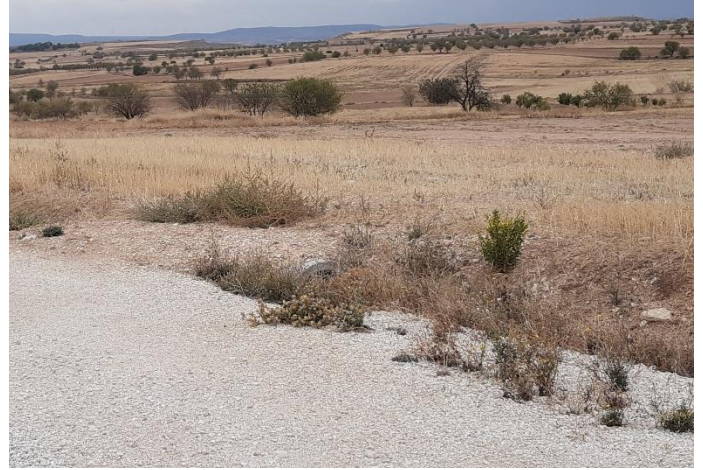
Fig. 2 Tubo de drenaje taponado por vegetación arbustiva en vial de acceso al aero L6C.06. Fuente: Elaboración propia
