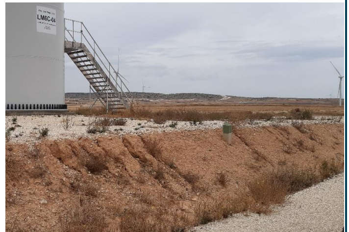
Fig. 4 Erosión hídrica en cimentación del aero LM6C.04. Fuente: Elaboración propia
