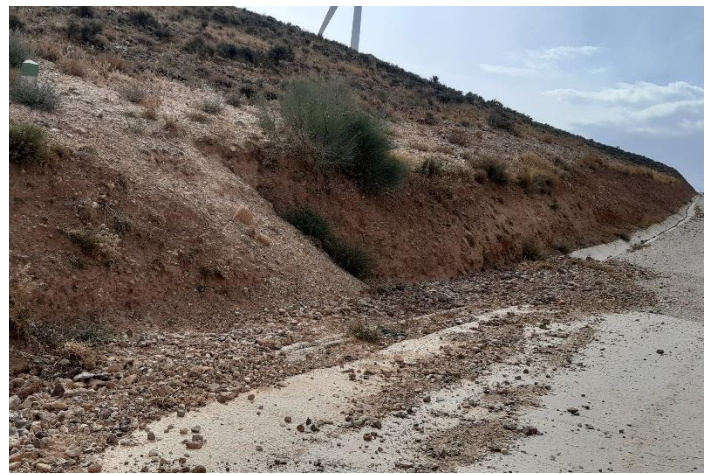
Fig. 4 Cuneta llena de sedimentos en vial de acceso al aero L6C.12. Fuente: Elaboración propia
