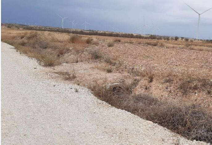
Fig. 1 Tubo de drenaje semitaponado con vegetación arbustiva en vial de acceso al aero L6C.04. Fuente: Elaboración propia
