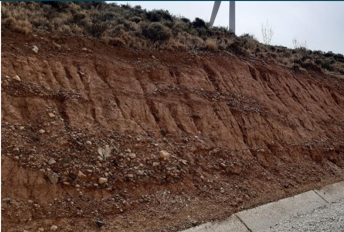
Fig. 1 Erosión hídrica en materiales lutíticos del talud de desmonte del vial de acceso al aero LM6C.12. Fuente: Elaboración propia
