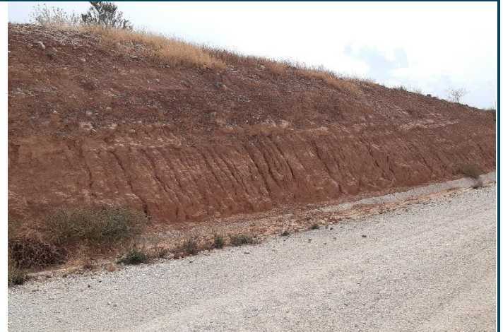
Fig. 2 Erosión hídrica en materiales lutíticos del talud de desmonte del vial de acceso al aero LM6C.11. Fuente: Elaboración propia
