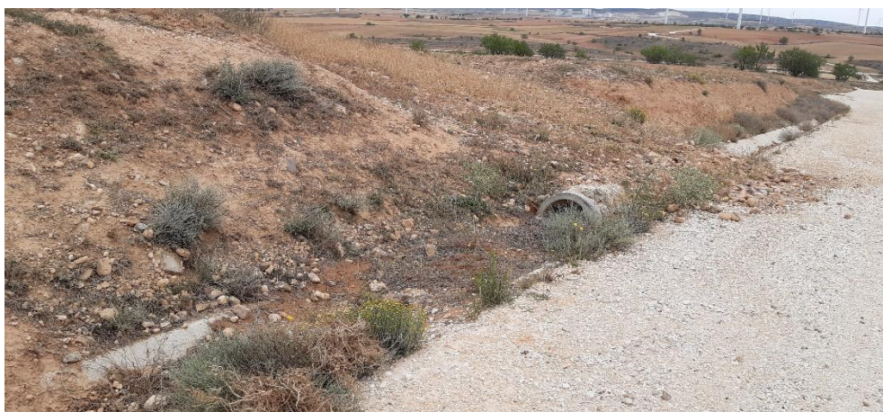
Foto 2. Tubo de drenaje y cuneta taponados por vegetación arbustiva y sedimentos en vial de acceso al aero L6B – 13.
