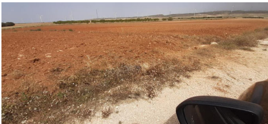
Imagen 1. Vial de acceso al aero LM2-07 con material vegetal en el drenaje.
