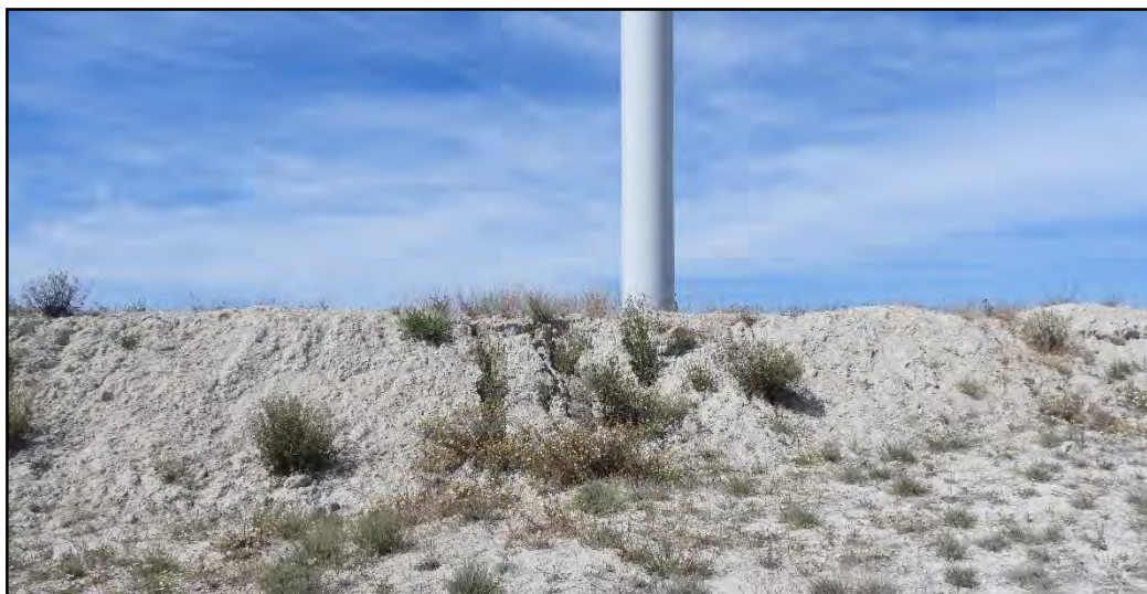
Fotografía 3. Pequeños regueros originados por escorrentía junto a la turbina HE04
