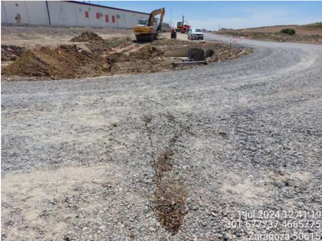
Imagen 1. Derrame de maquinaria trabajando en zanja. Se para la máquina hasta que se repara.
