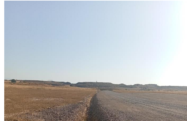
Fotografías 2 a 5: Estado de caminos y viales
