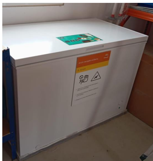
Ilustración 2. Arcón congelador ubicado en la SET
