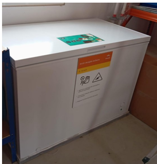
Ilustración 2. Arcón congelador ubicado en la SET
