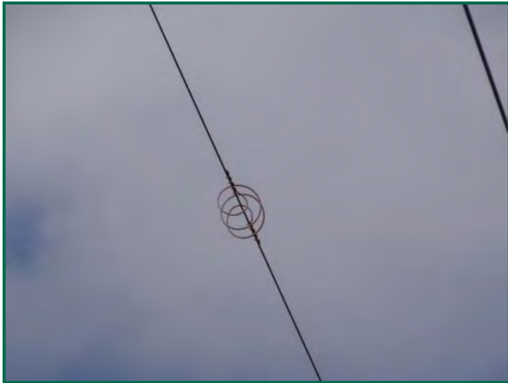
Fotografía 7. Detalle de balizas salvapájaros.
