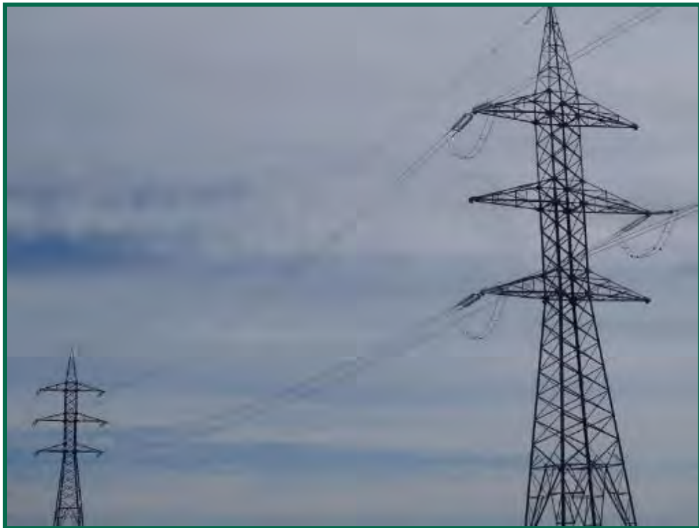
Fotografía 6. Apoyos LAAT evacuación.
