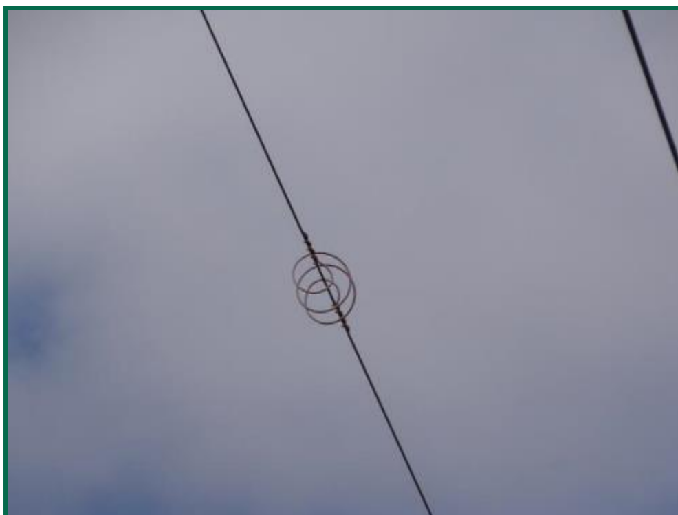
Fotografía 7. Detalle de balizas salvapájaros.
