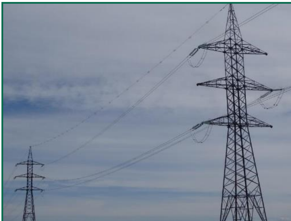
Fotografía 6. Apoyos LAAT evacuación.
