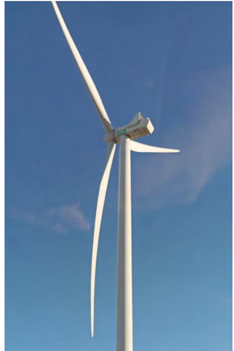
Fotografías 7 y 8. Barquillas de los aerogeneradores sin derrames de aceite.
