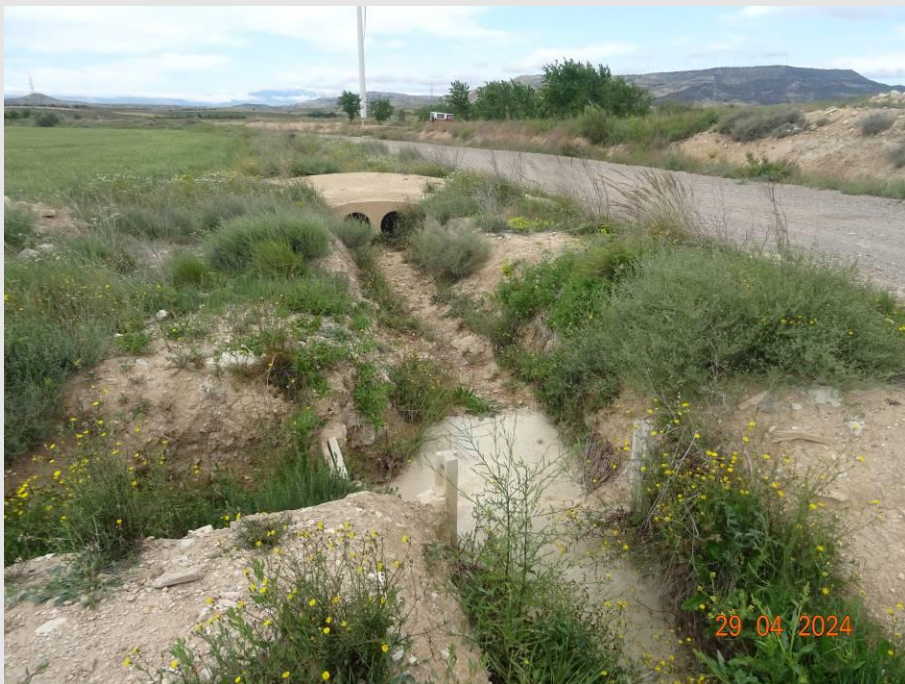
Fotografía 10. Sistema de drenaje situado cerca de las instalaciones.
