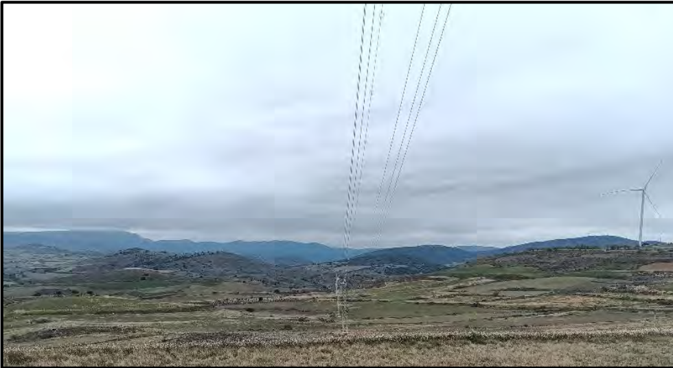
Fotografía 2. Vista general de la línea eléctrica
