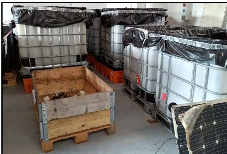
Fotografía 14. Vista general del Punto Limpio de la subestación "Pedregales" (26/03/2025)
