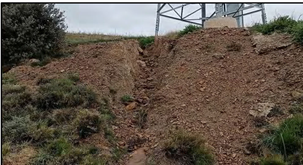
Fotografía 3. Situación actual del reguero en la base del apoyo LCAS01.
