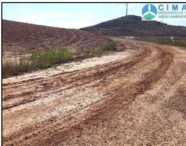
Fotografía 2. Estado del vial principal entre las turbinas CAS02 y CAS03 tras los eventos de lluvia
