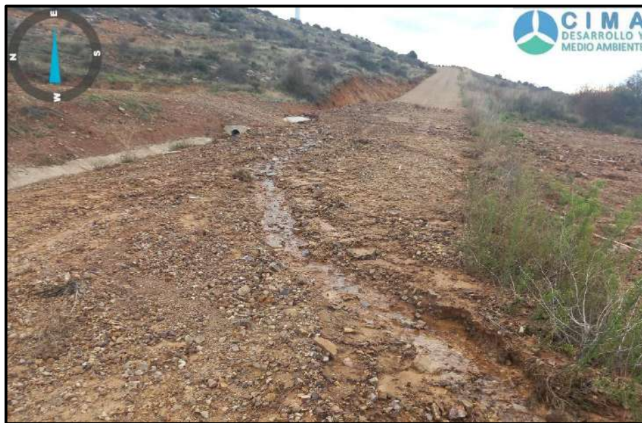
Fotografía 3. Reguero y transporte de sedimento en el vial principal a la altura de la turbina CAS02
