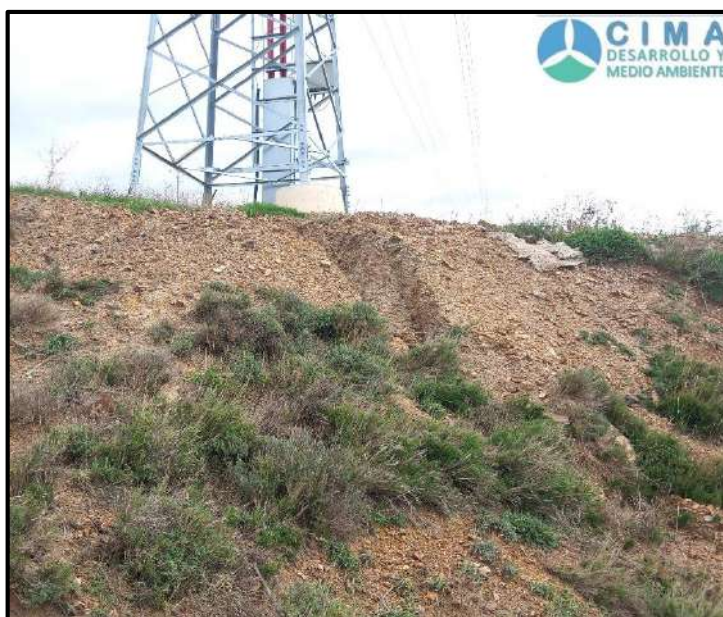
Fotografía 6. Situación actual del reguero en la base del apoyo LCAS01.
