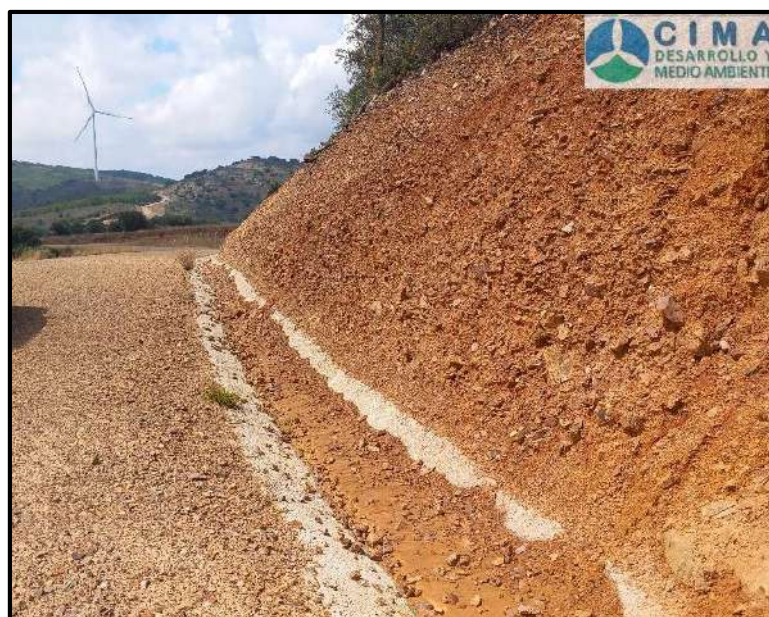
Fotografía 4. Ejemplo de cuneta colmatada.
