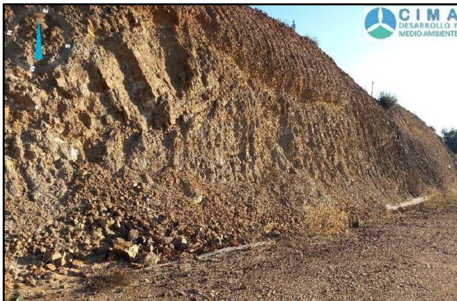
Fotografía 5. Ejemplo de pequeño desprendimiento del terreno.
