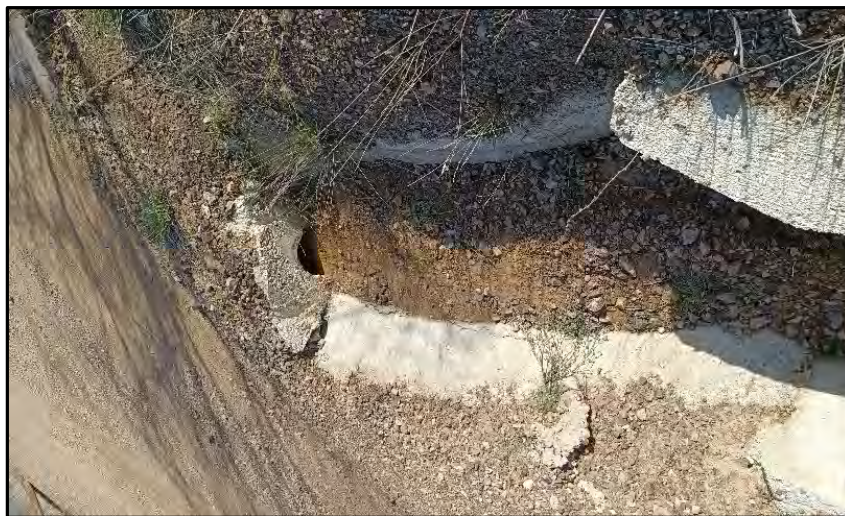
Fotografía 3. Colmatación parcial de un paso de agua en el vial principal del parque eólico
