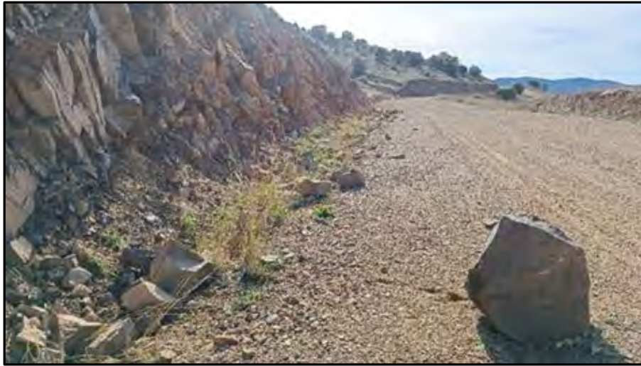
Fotografía 1. Derrumbes a la altura de la antena meteorológica del parque eólico “El Castillo”.
