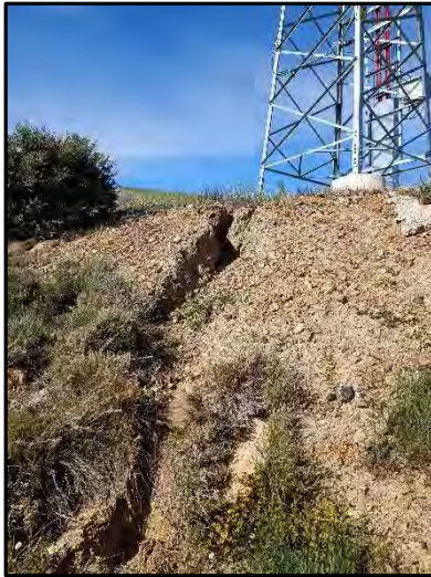
Fotografía 4. Situación actual del reguero en la base del apoyo LCAS01
