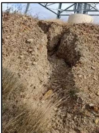
Fotografía 5. Evolución del reguero en la base del apoyo LCAS01 de la línea eléctrica del parque eólico “El Castillo”
