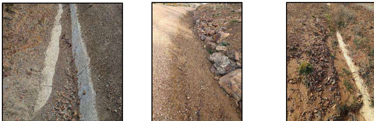
Fotografía 4 Colmatación de la cuneta de menor (izquierda) a mayor intensidad (derecha)
