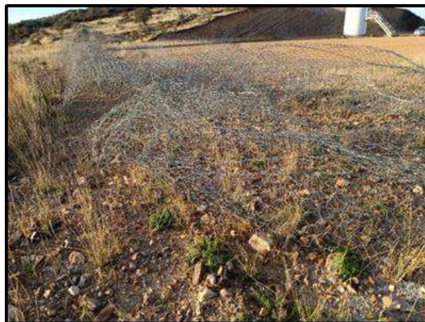
Fotografía 8. Malla de contención pendiente de retirada en la plataforma de la turbina CAS01
