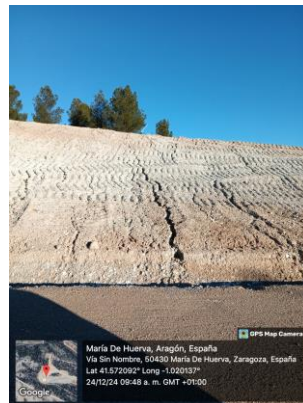
Fig 2. Formación de cárcavas en talud hidrosembrado CAM-01
