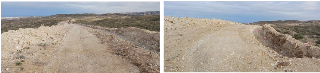
Fig 1 y 2. Excavación y acopio de materiales en el entorno de la zanja de la línea de evacuación
