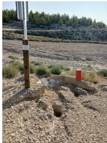
Fig 2. Erosión en el vial principal, en el desvío a la CAM-01
