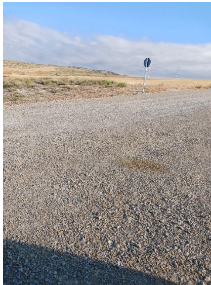
Figura 1: Mancha de aceite en el vial entre el aerogenerador 12 de El Cabezo y la parcela de la pala caída
