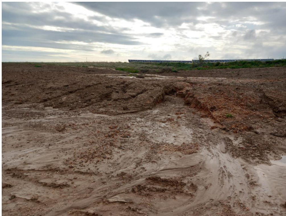
Foto 4: afección por erosión en la plataforma del aerogenerador CN3-05.
