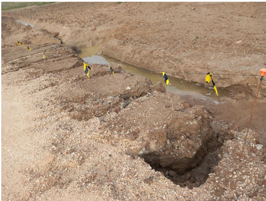
Foto 5: afección por erosión en la plataforma del aerogenerador CN3-05.
