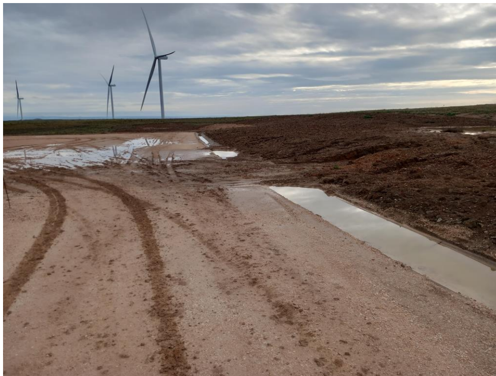
Foto 3: afección por erosión en la plataforma del aerogenerador CN3-05.
