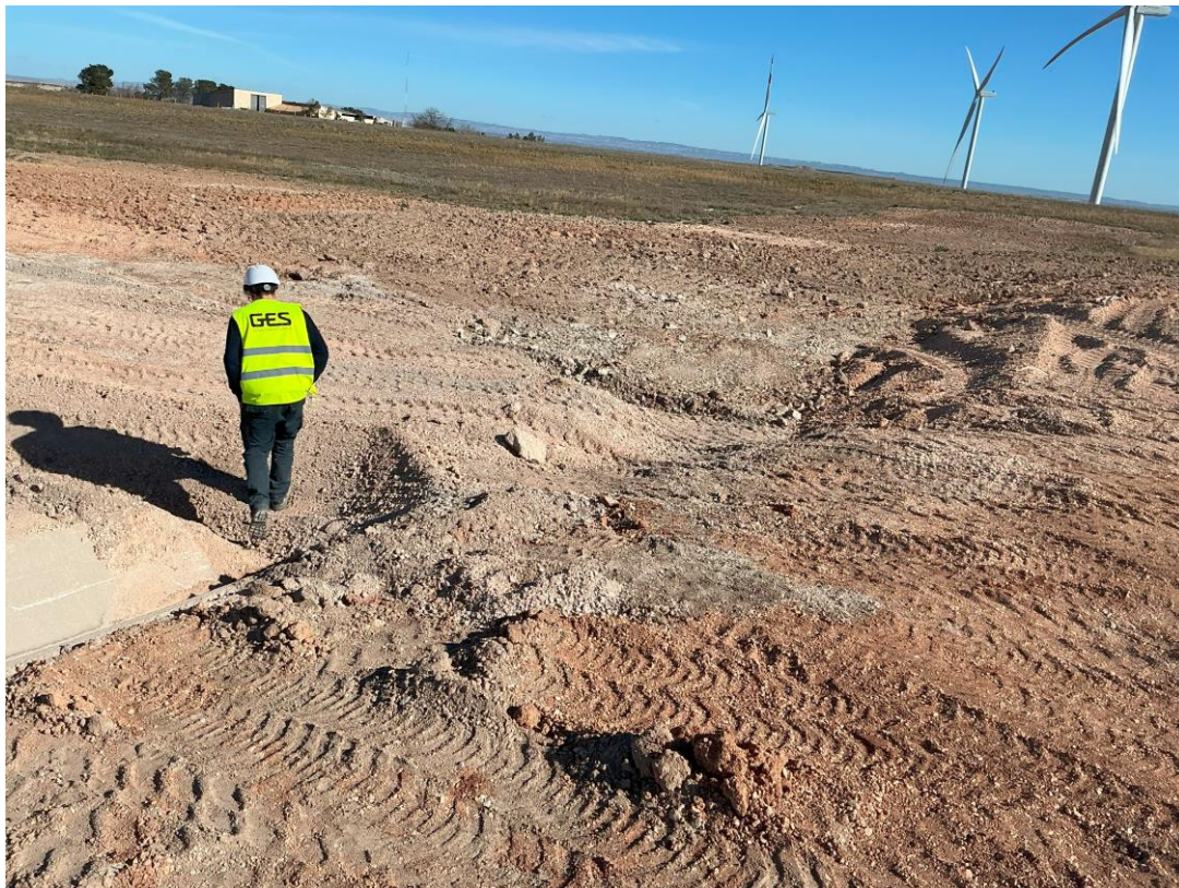
Foto 6: rodadas y falta de nivelación de terreno en plataforma.
