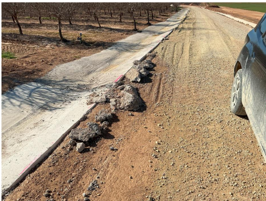
Foto 6: restos de hormigón procedentes de la ejecución de zanja.
