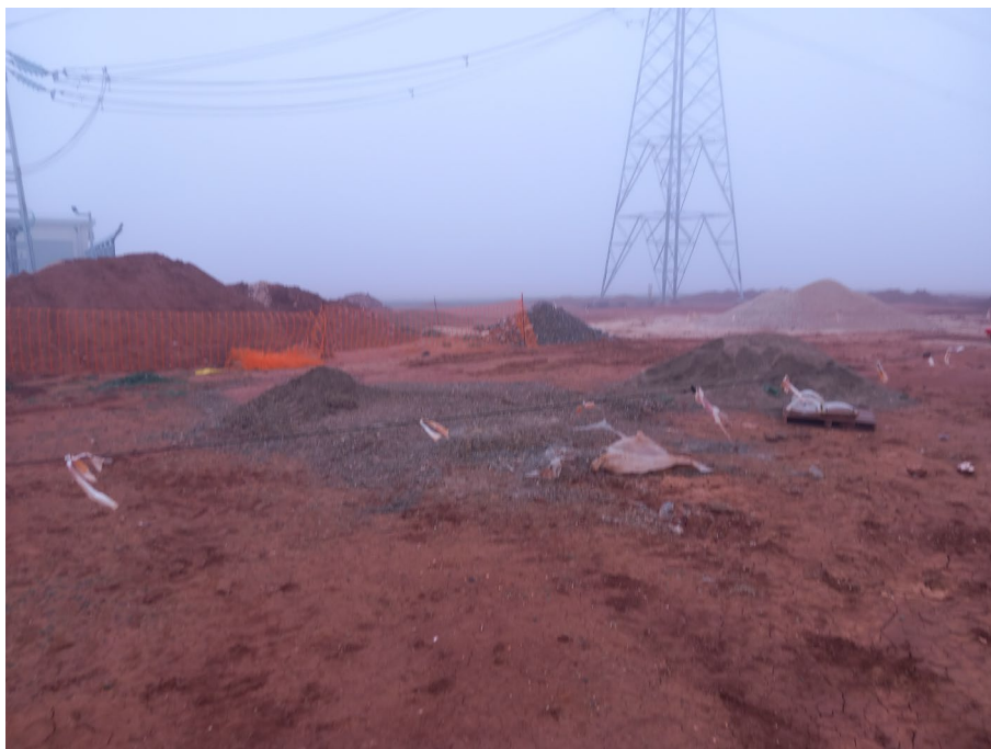
Foto 3: Acopio de zahorra en el entorno de la SET con acumulación de residuos
