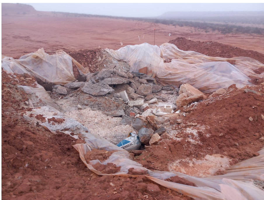
Foto 4: Estado deficiente de la balsa de hormigón en la SET.
