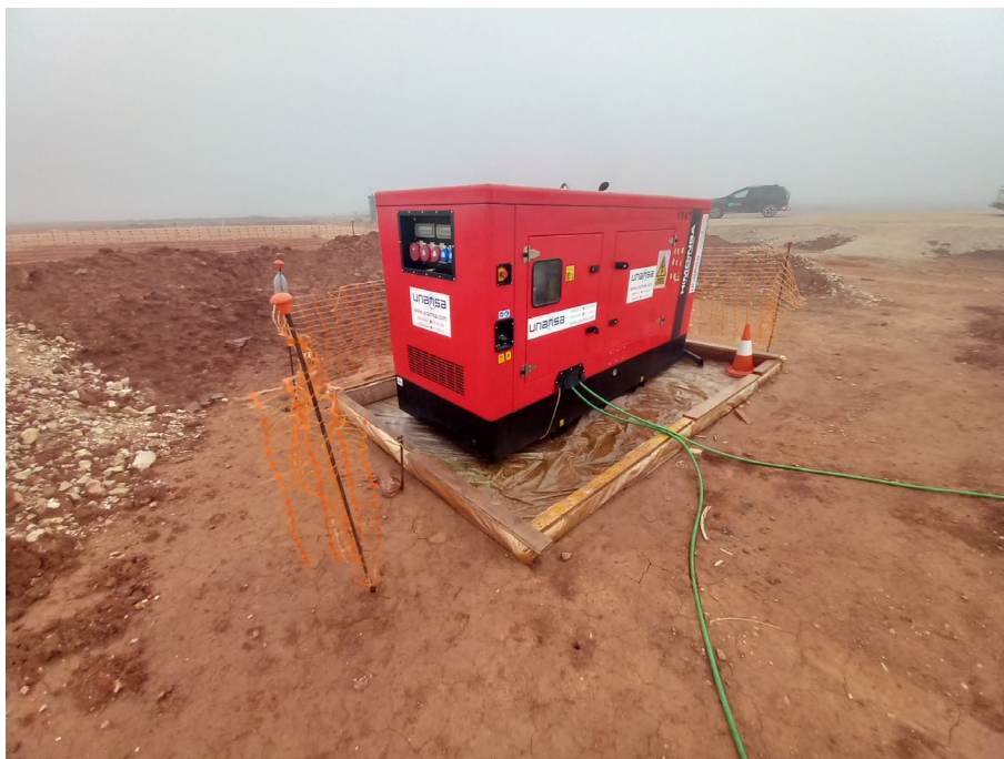
Foto 5: Grupo electrógeno debidamente instalado con sistema antiretención.
