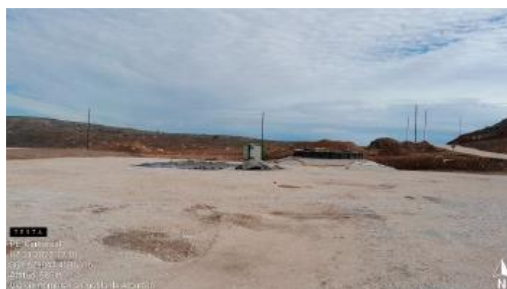
Restos hormigón CANI-09
