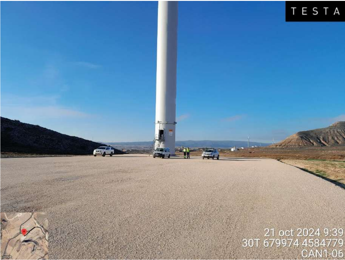
Imagen 1. Trabajos internos en el aerogenerador CAN1-06
