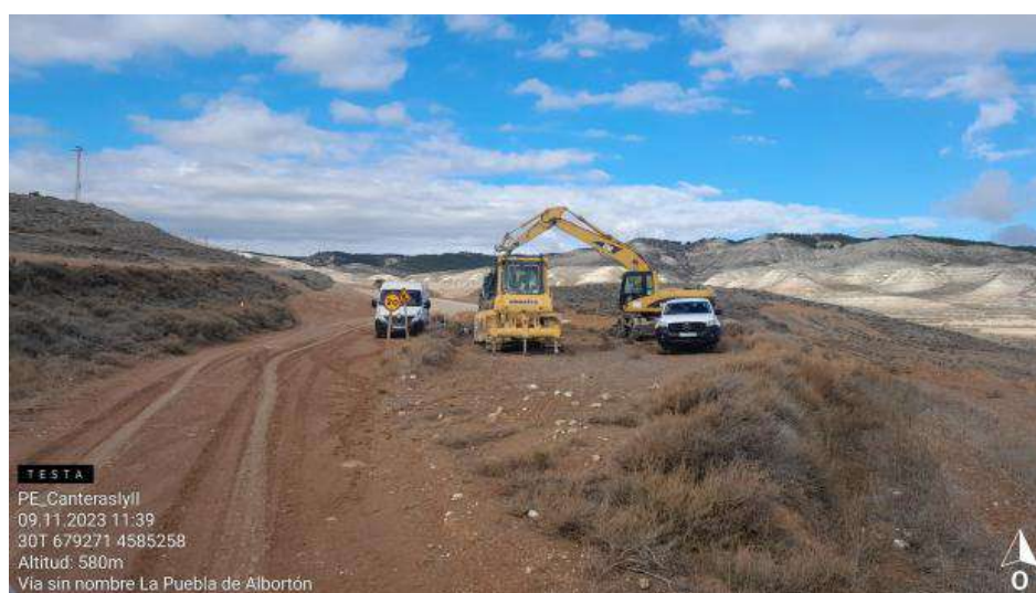
Reparación de maquinaria sobre suelo sin protección.
