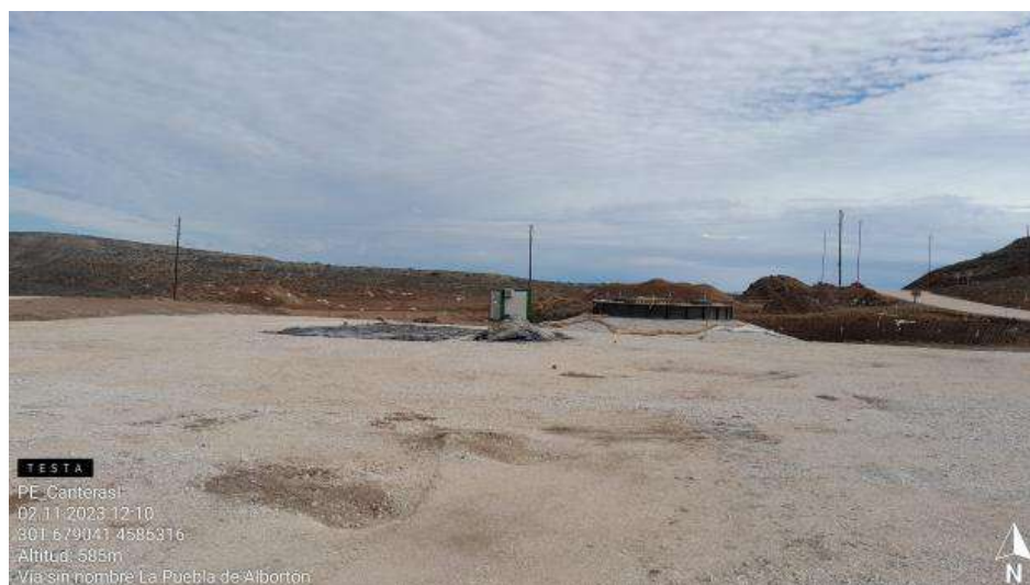
Restos de hormigón en CN1-8
