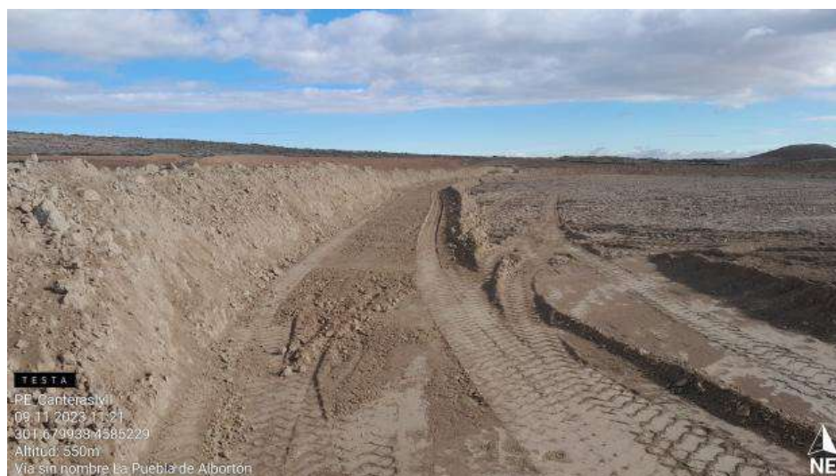
Separación de tierras insuficiente en CNI-7
