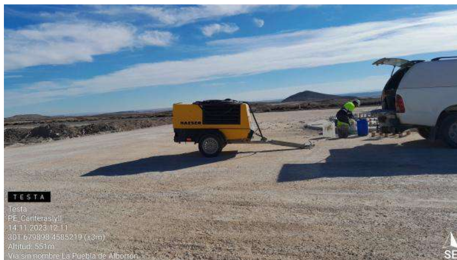
Generador sin protección de suelo en CNI-7.
