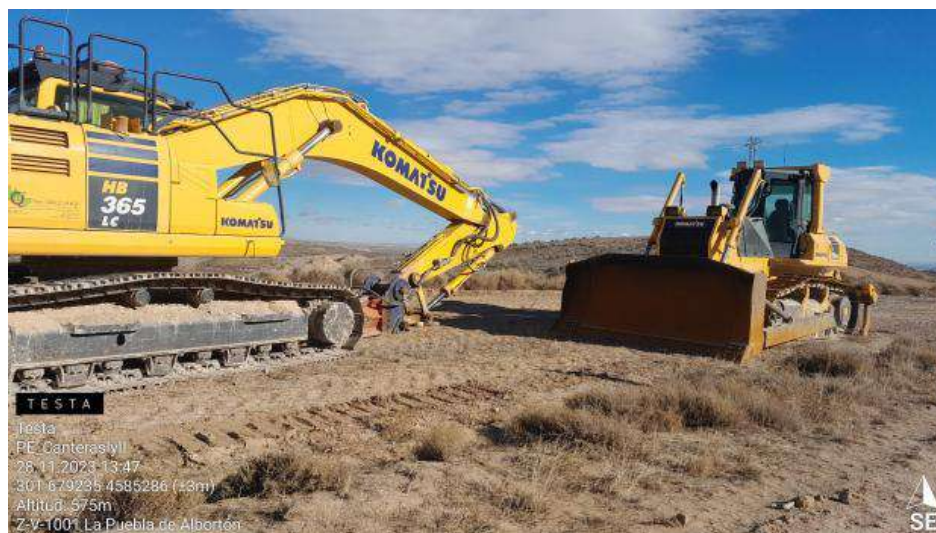
Maquinaria estacionada indebidamente cercana a CNT1-8.
