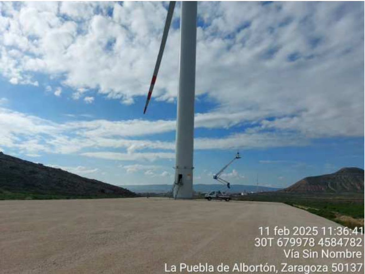
Imagen 1. Trabajos de puesta a punto del sistema 3D Observer en CAN1-06.
