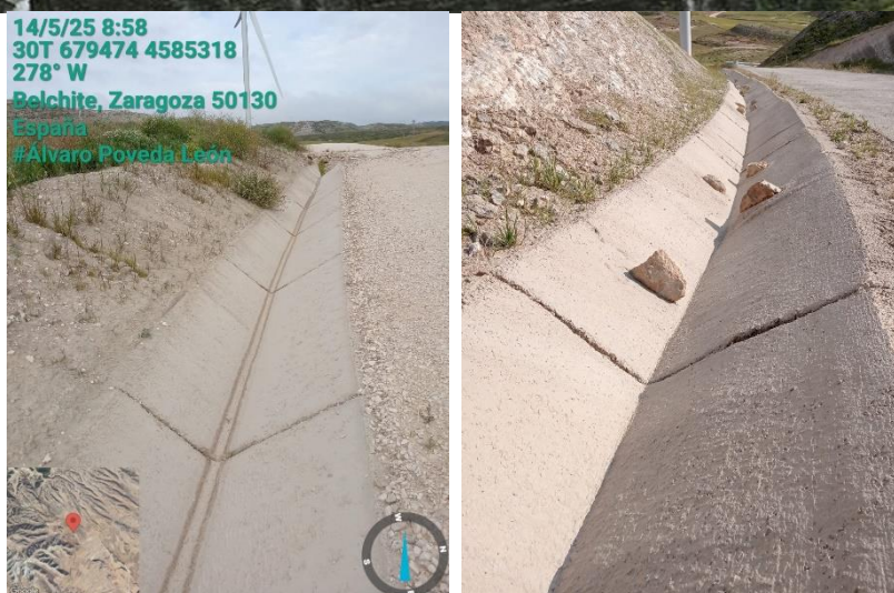
Fotografías 16 a 17. Infraestructura de drenaje
