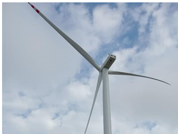
Fotografías 2 y 3: Barquillas de los aerogeneradores sin derrames de aceite.
