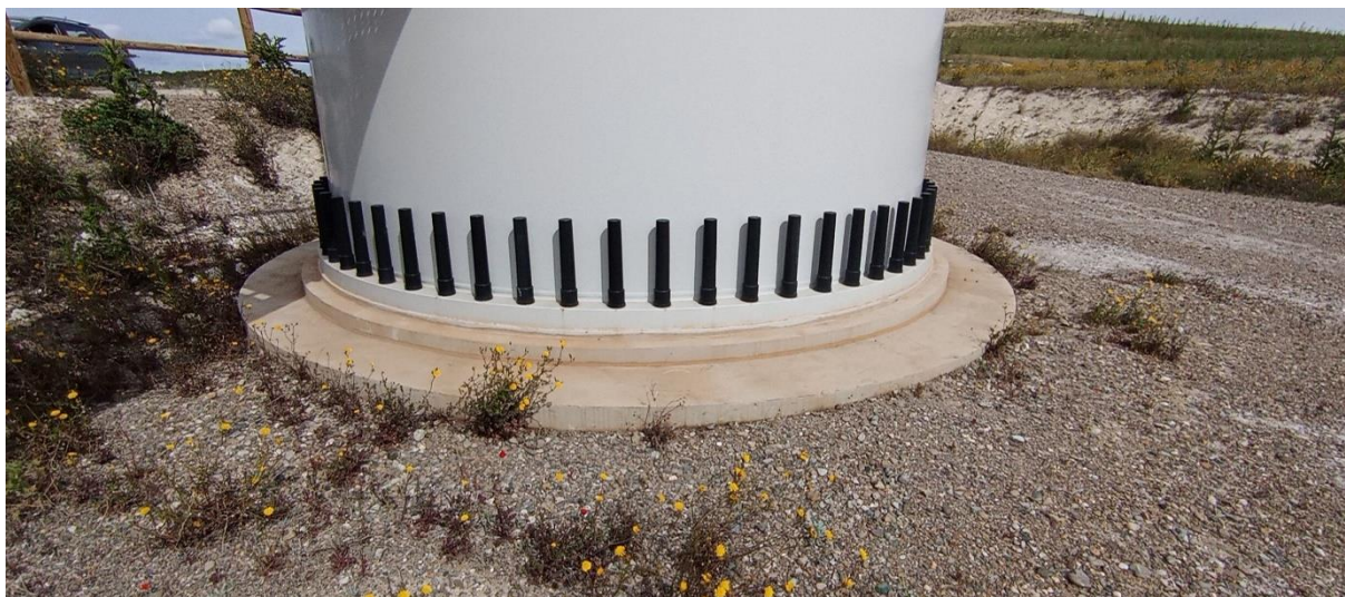
Fotografía 13: Bases de las torres de los aerogeneradores
