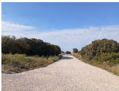
Fotografía 10 a 12. Estado viales
