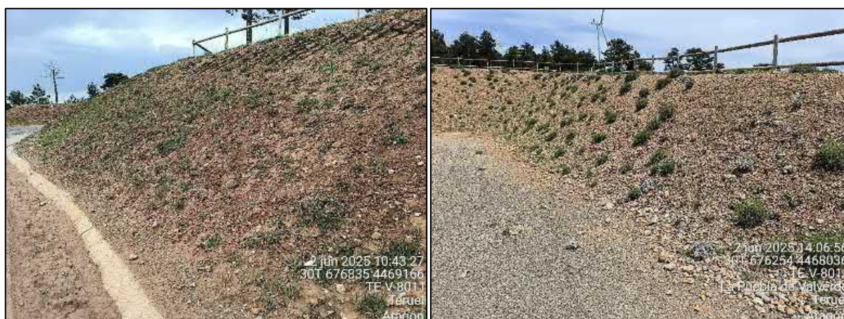
Figura 17: Estado de los taludes, con revegetación natural muy tímida y las plantas de la hidrosiembra secas.
