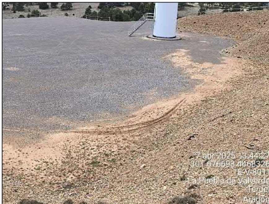
Figura 14: Pequeña colada sedimentaria depositada en la plataforma del aerogenerador APE-01.
