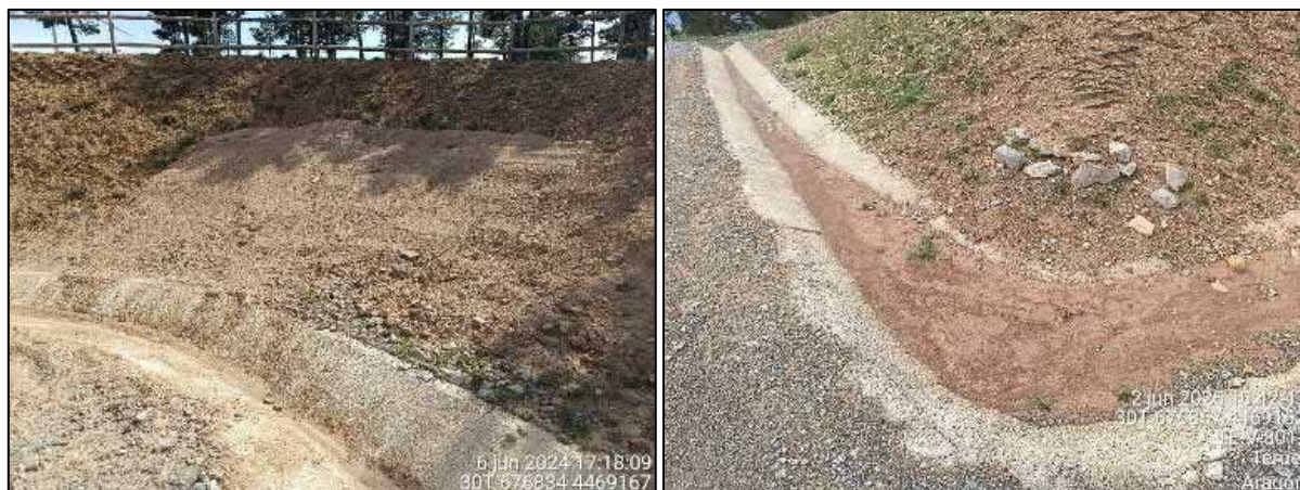
Figura 16: Cunetas del aerogenerador APE-05 en junio de 2024 (izda) y junio de 2025 (dcha)
