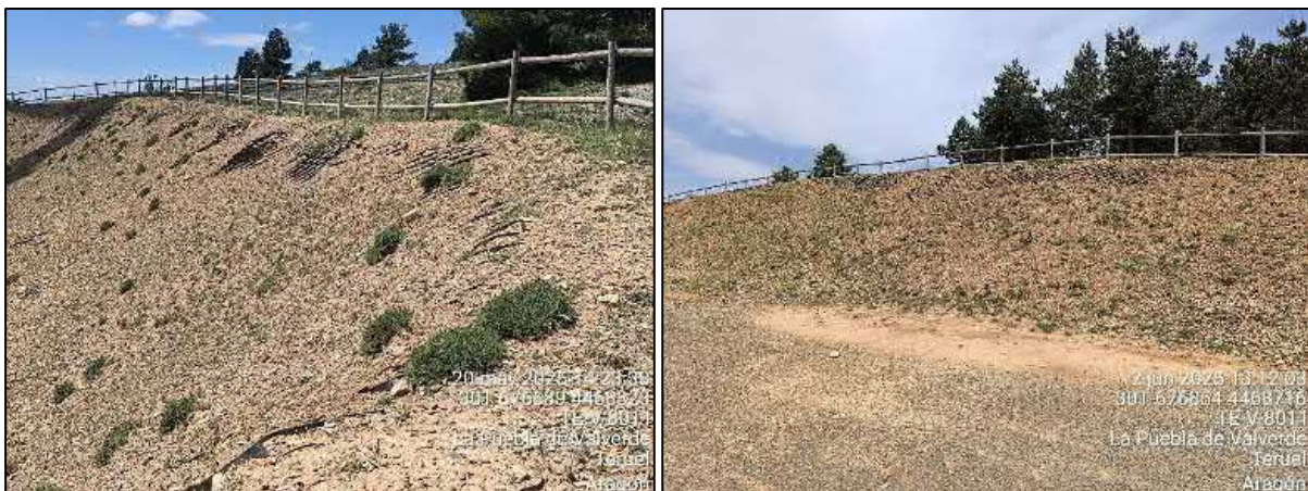
Figura 15: Geomalla textil descubierta en los taludes de los aerogeneradores APE-04 y APE-06
