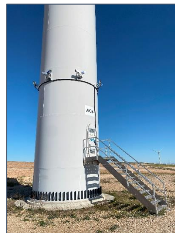
Dispositivo 3DObserver instalado en el aerogenerador A-04
